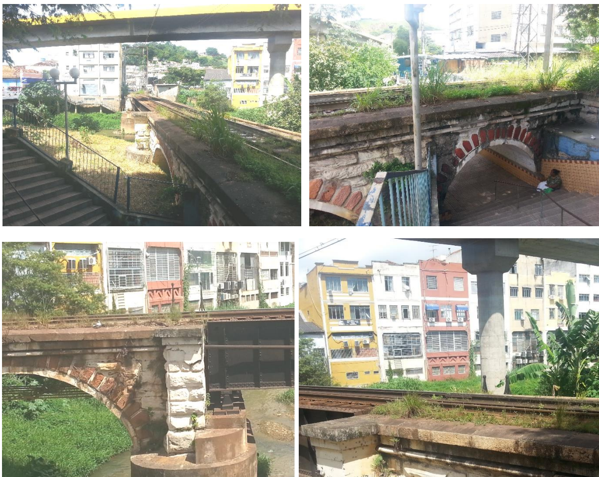
Figuras 121 a 124 – Ponte da Barra vista a partir da ponte ao lado, e de uma das passagens subterrâneas. Detalhes permitem ver resquícios do guarda-corpo (2017 e 2018).
