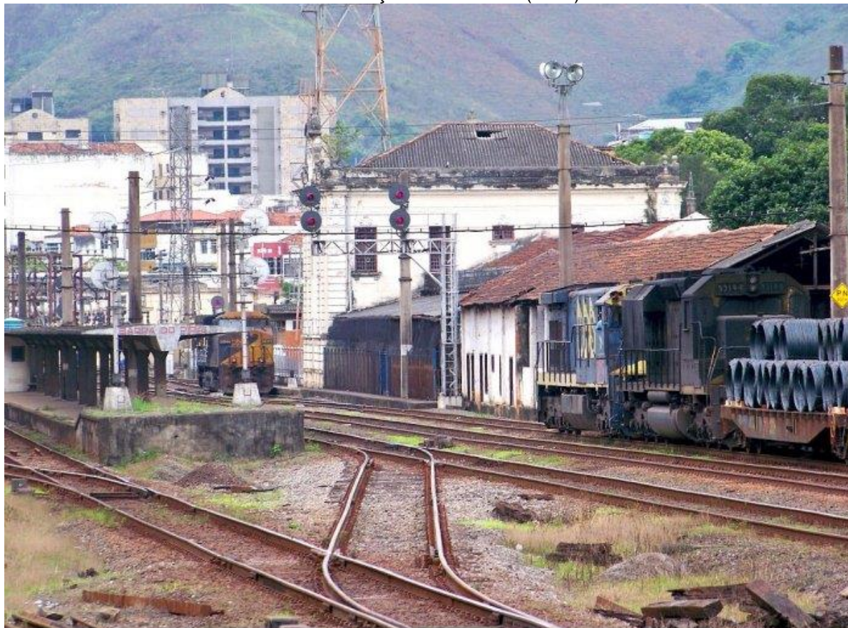
Figura 93 – Fachada posterior da Estação e os galpões anexos. Nota-se já nesta data o crítico estado de conservação da cobertura (2010).
