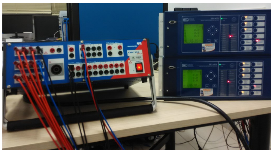
Figura 5.1: Equipamentos montados no laboratório
