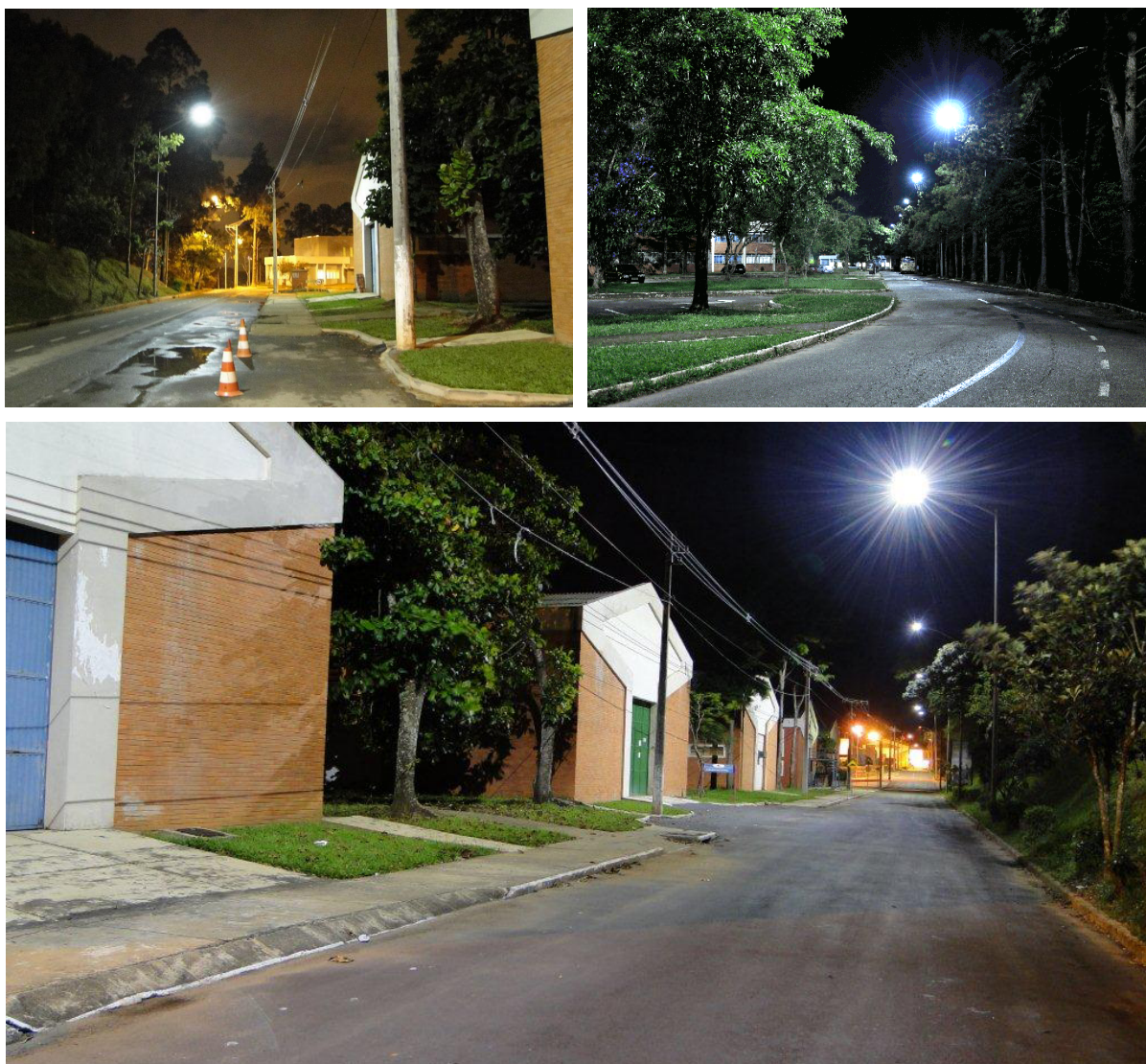
Figura 4.24 – Iluminação a LEDs na Universidade Federal de Juiz de Fora (Fotos: NIMO/UFJF – Núcleo de Iluminação Moderna/ Universidade Federal de Juiz de Fora).
