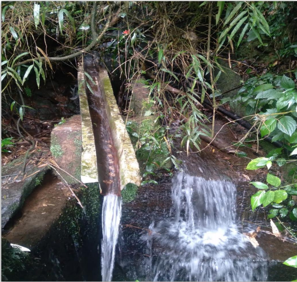
Figura 19. Canal de primeira ordem canalizado abaixo da rodovia e drenado pelo ribeirão Jacutinga
