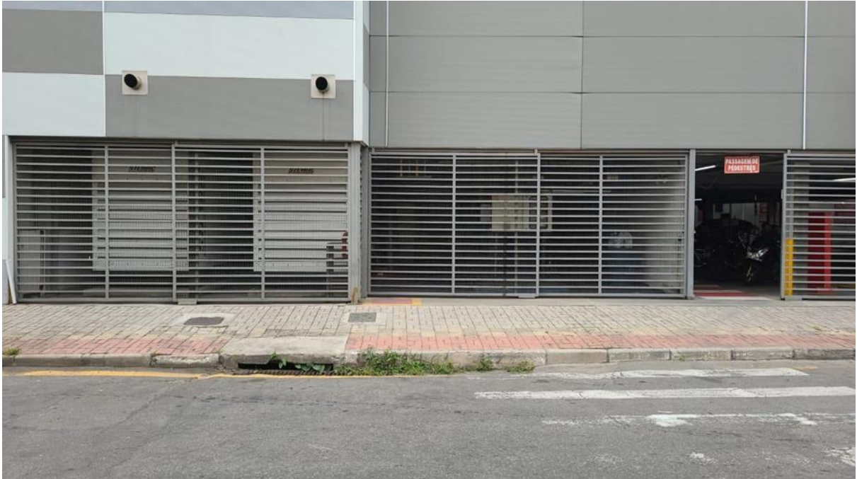
Figura 14: Geradores do mercado com a exaustão voltada para rua onde moram os avós das crianças
