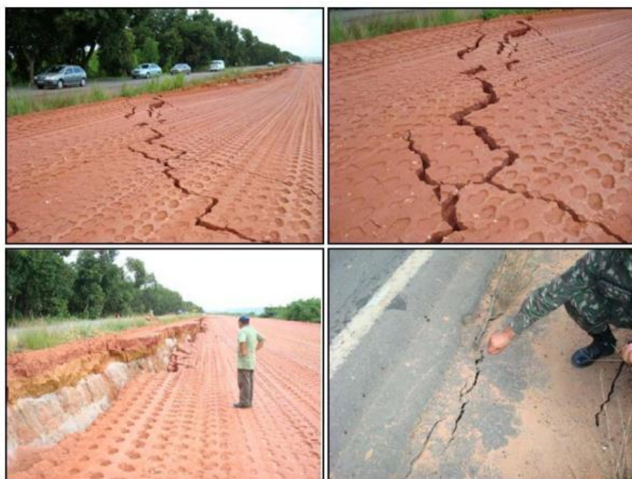
Figura 29 – Ruptura do Aterro 5, rodovia BR-101/PE
