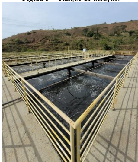
Figura 5 – Tanque de aeração.
