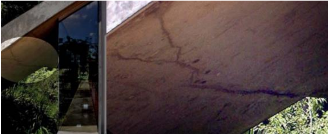
Figura 18 - Problemas Estruturais na Residência Milan
