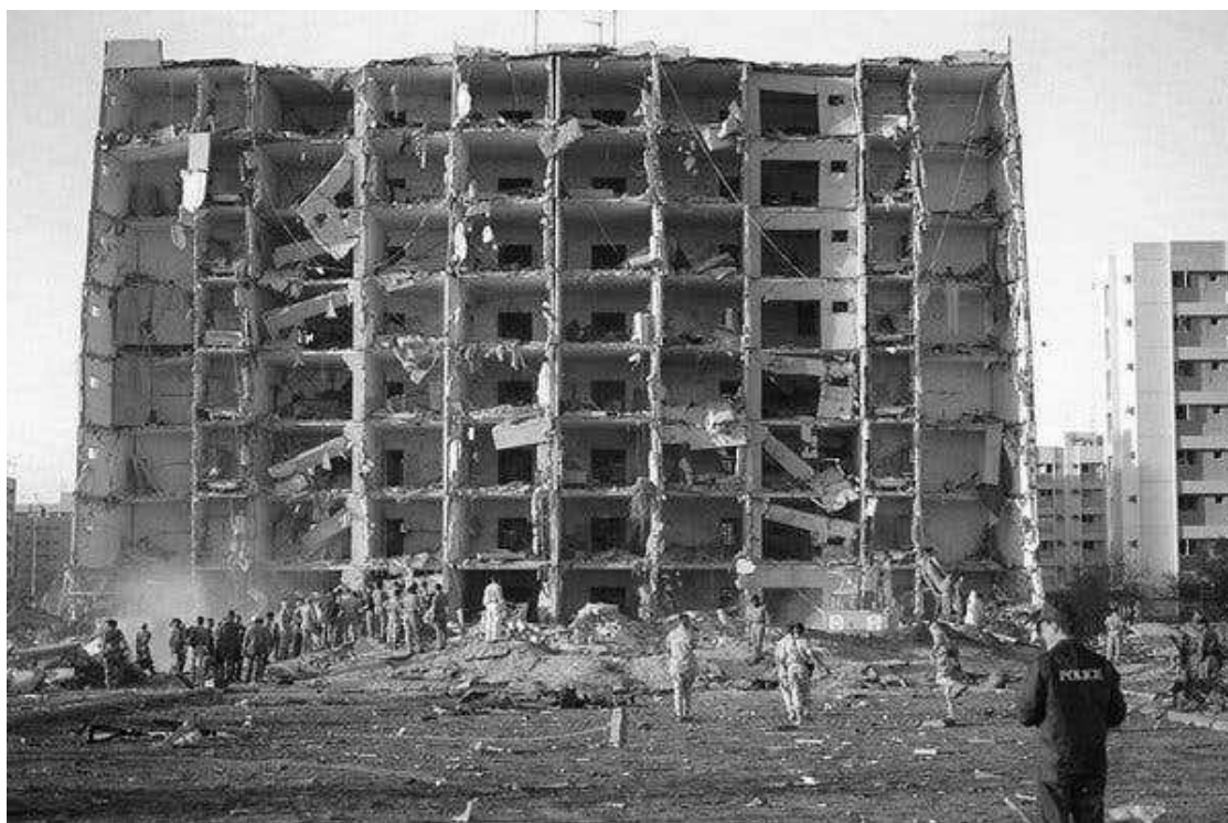
Figura 8 - Danos gerados à fachada do edifício mais próximo da explosão
