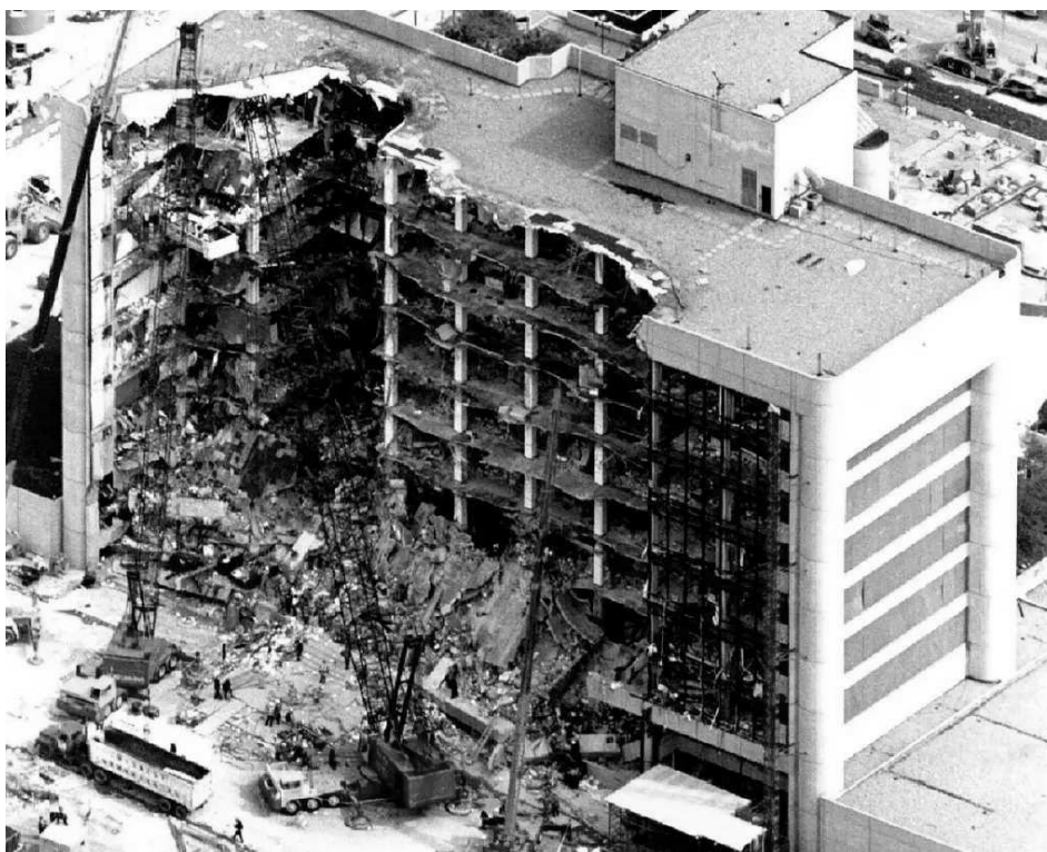
Figura 6 - Alfred P. Murrah Federal após colapso progressivo
