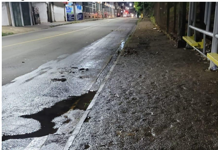
Figura 13 – Poça em frente ao ponto de ônibus no lado A
