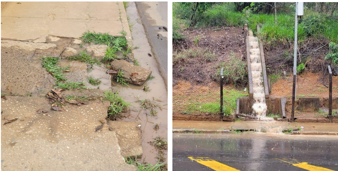
Figuras 19 e 20 – Situação da calçada no Trecho 4 / escoamento das águas pluviais
