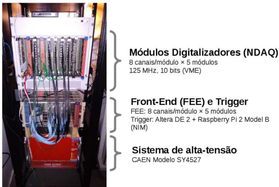
Figura 4 – Rack contendo a eletrônica de aquisição
