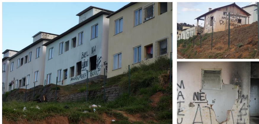
Figura 48 – Depredação da unidade habitacional.
