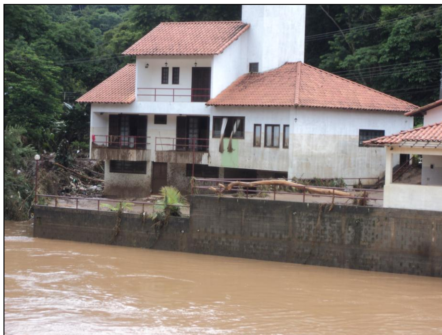
Figura 4.52 – Marca da altura que a água atingiu na fachada do imóvel. Setor Morro Grande.
