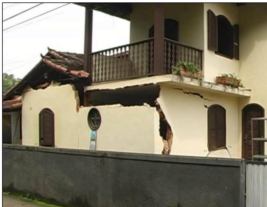
Figura 4.47 – Casa destruída pela erosão da margem fluvial, setor Ginásio. (Obs.: o rio Preto passa atrás da casa) Fonte: Foto cedida pela Prefeitura Municipal de Areal, 2012.
