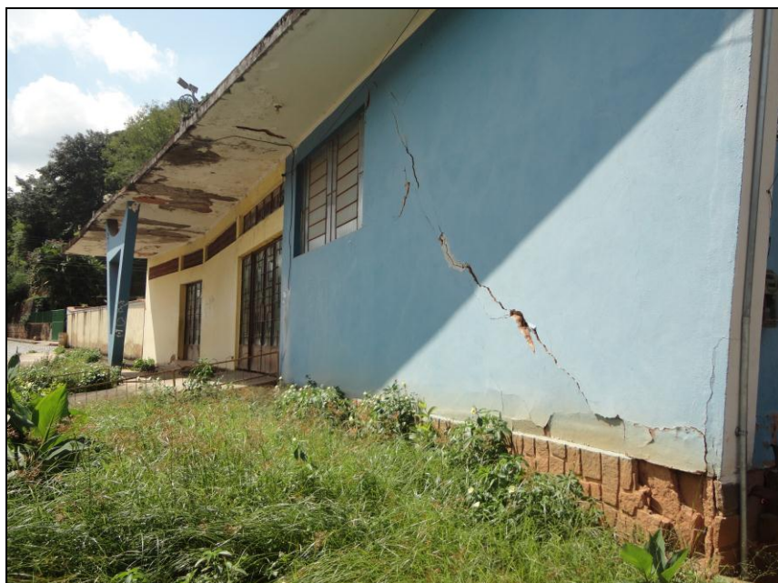
Figura 4.48 – Prédio do Ginásio que teve a estrutura abalada, setor Ginásio. Fonte: Foto cedida pela Prefeitura Municipal de Areal, 2012.
