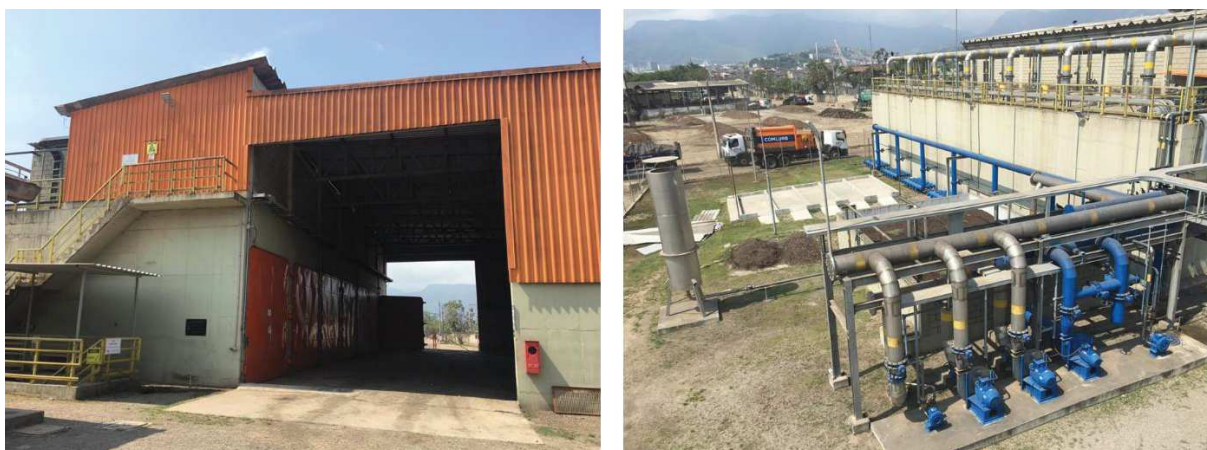
Figura 6: Sistema TMethar – Usina do Caju (Rio de Janeiro – RJ).
