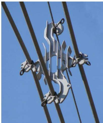
Figura 7 - Rede aérea protegida.
