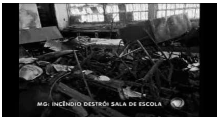
Figura 3 – Incêndio atinge escola em Santa Luzia – MG
