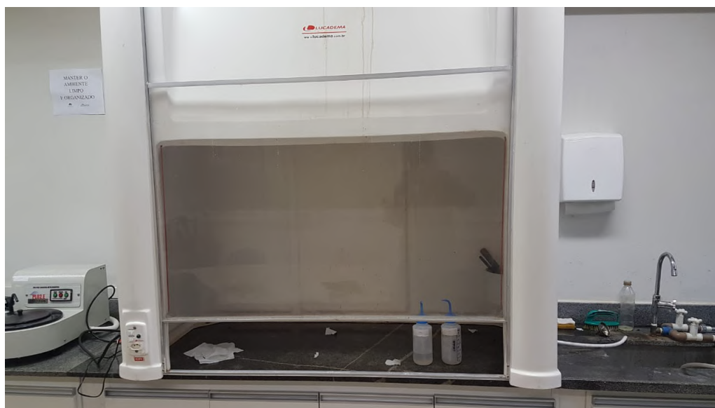
Figura 30 – Capela para realização de ataques químicos
