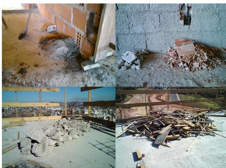
Figura 19 - Pilhas de resíduos dispostas ao longo da obra: argamassa, tijolo, concreto e madeira.
