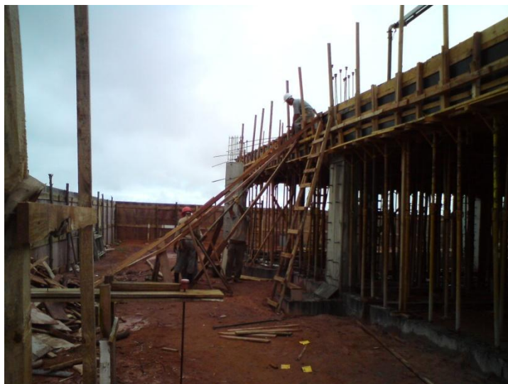
Figura 28 - Madeira proveniente de desforma da estrutura disposta de forma irregular.
