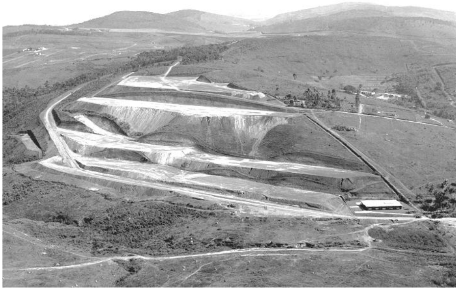
Figura 15 – Obras de terraplenagem do setor oeste do campus , para construção de 4 do total das 8 plataformas.
