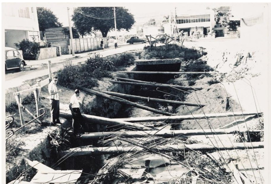
Figura 47: Av. Independência, obra de canalização do córrego central, década de 1970 (Arquivo de Ramon Brandão). Possivelmente 1966. Disponível em: < http://mariadoresguardo.blogspot.com.br >.
