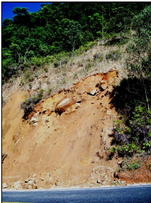
Foto 7.31. Evidência de movimento de massa na forma de escorregamento em corte de estrada afetando CAMBISSOLOS em Cristina (MG).
