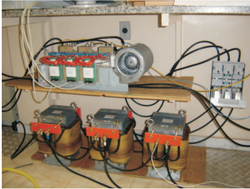
Figura 6.3: Foto do Conversor VSI No. 1 e Transformadores de Conexão.
