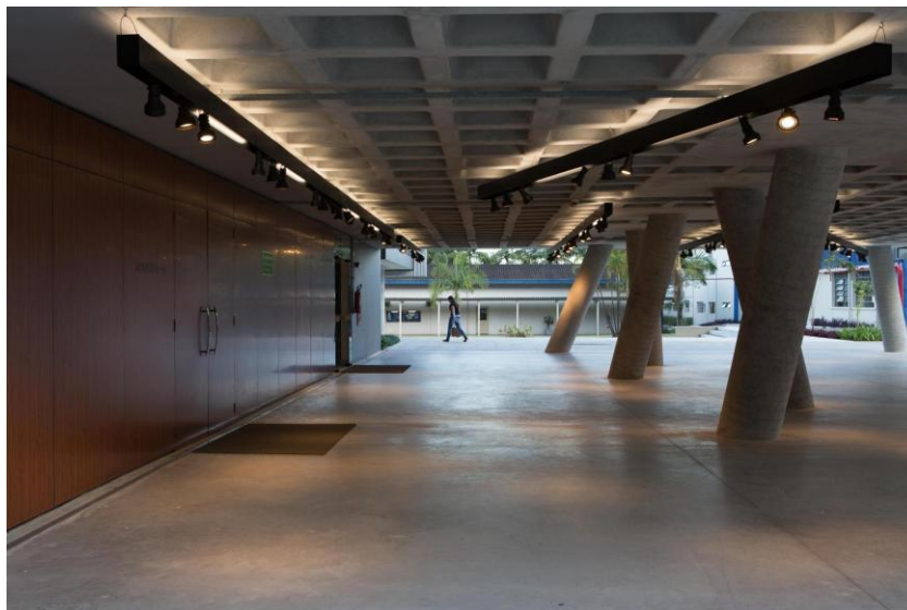
Figura 33 - Fotografia das instalações e estrutura aparentes. Autoria: Pablo Teixeira
