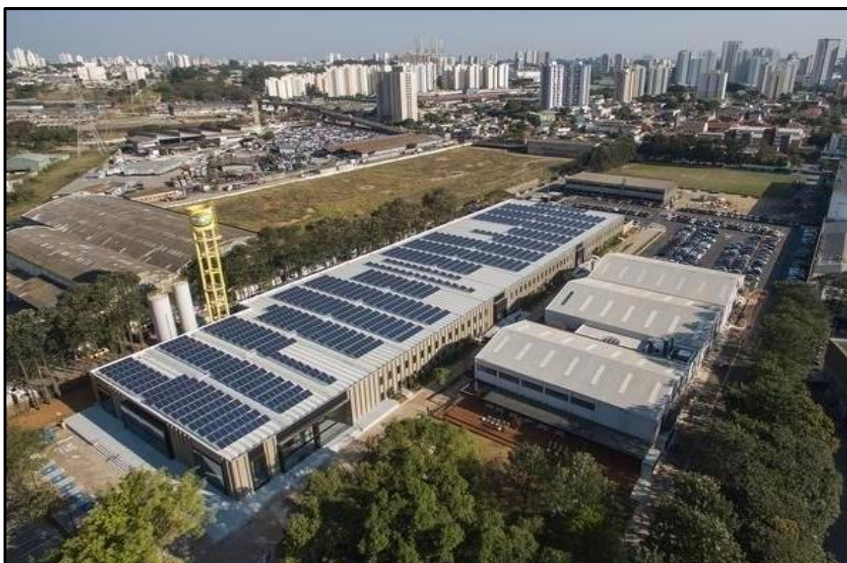
Figura 60 - Conjunto de Painéis Fotovoltaicos implantados na sede da empresa Mercado Livre, em São Paulo
