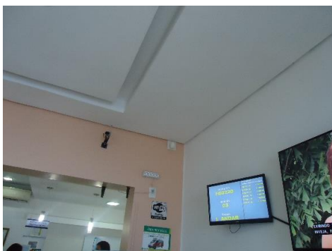
Figura 61: Instalações elétricas no interior do edifício
