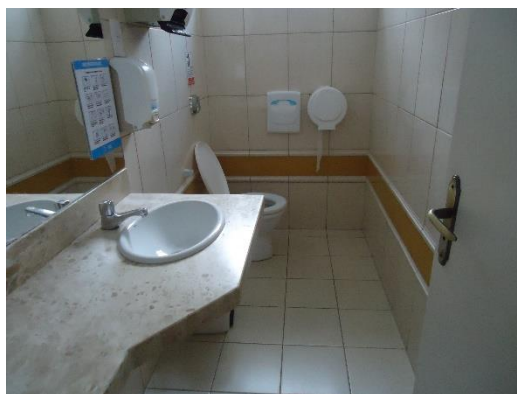
Figura 60: Uma das instalações hidro-sanitárias no interior do edifício
