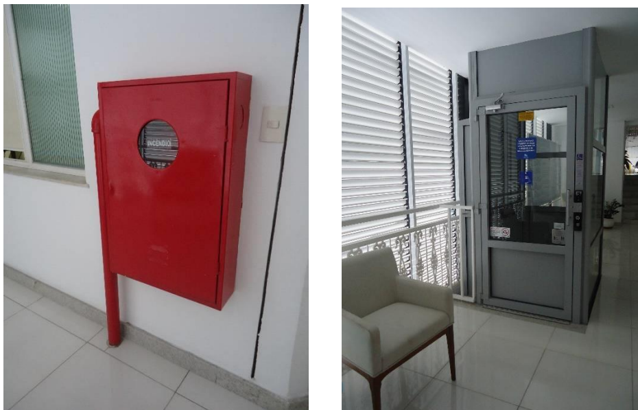
Figura 62: Instalações contra incêndio (à esquerda) e elevador para portadores de necessidades especiais (à direita)
