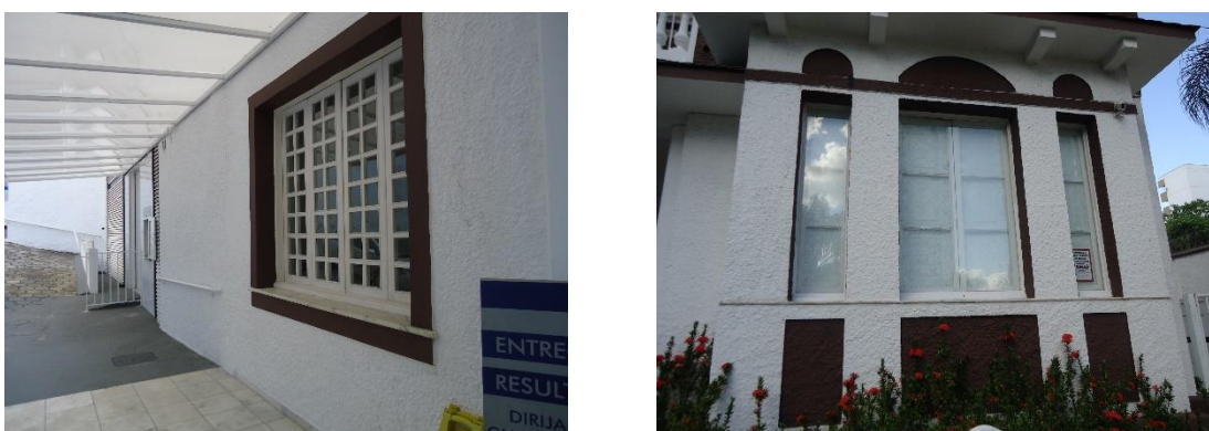
Figura 55: Janela em formato retangular (à esquerda), e janelas da fachada frontal (à direita)
