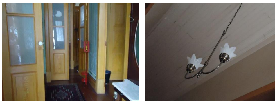
Figura 24: Indicativo de instalações de segurança e incêndio, com a ausência do extintor (à esquerda), e uma das instalações elétricas (à direita)
