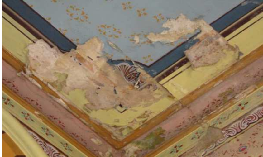
Foto 8: Lateral do teto com rachaduras e infiltração de água da chuva. Arquivo da autora. Em 08/09/2013.
