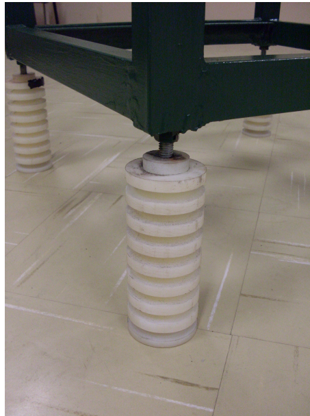
Figura 4.9: Pés de nylon responsáveis pelo isolamento do rack externo.
