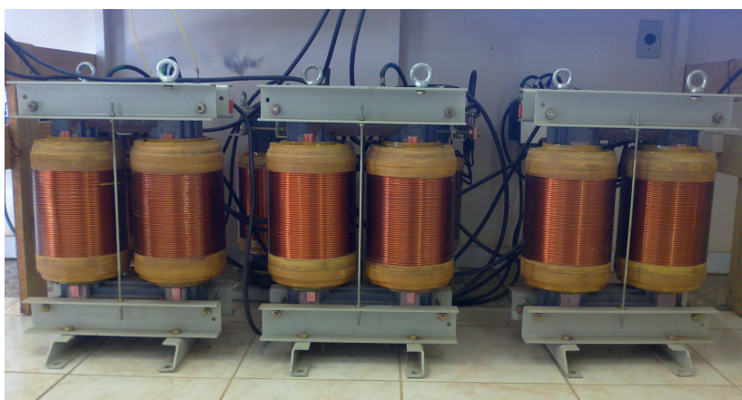
Figura 38: Detalhe do banco de transformadores de conexão.
