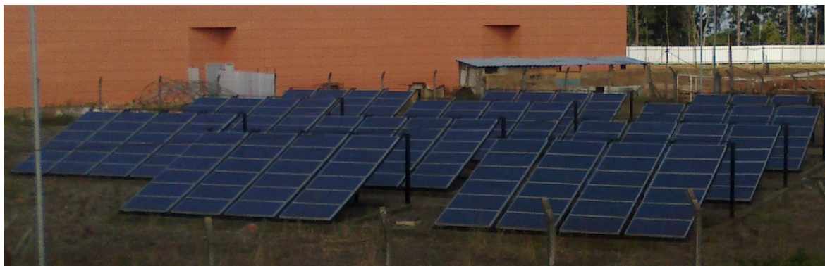
Figura 1: Foto dos arranjos fotovoltaicos da usina solar da UFJF.
