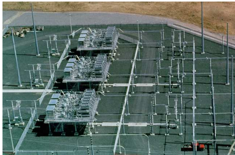
Figura 2.5: TCSCs instalados na subestação de BPA's C.J.Slatt na linha Slatt-Buckley de 500 kV em Northern Oregon
