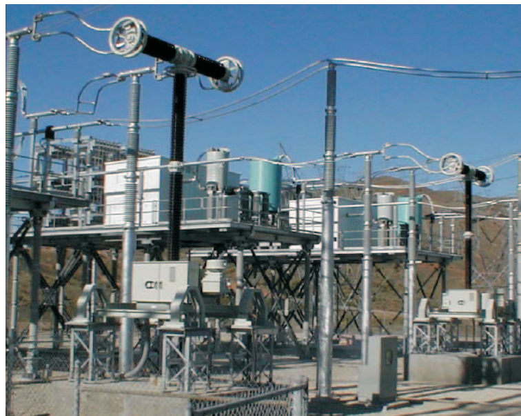
Figura 2.3: TPSCs 500 kV instalados na subestação em Vincent/USA
