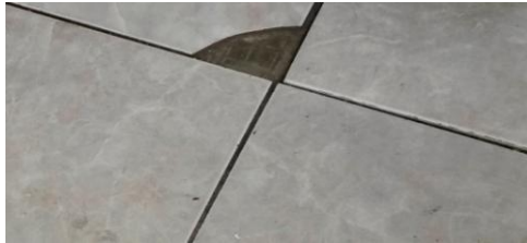
Figura 29 - Piso quebrado - domicílio C Fonte: Acervo da autora, 2015
