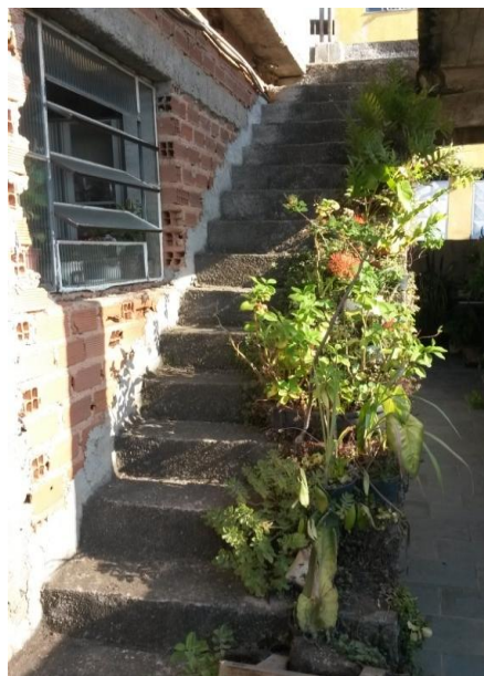
Figura 32 - Escada sem corrimão - domicílio C Fonte: Acervo da autora, 2015
