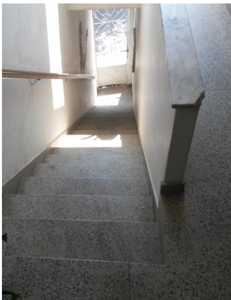
Figura 31 - Escada de acesso - domicílio D Fonte: Acervo da autora, 2015
