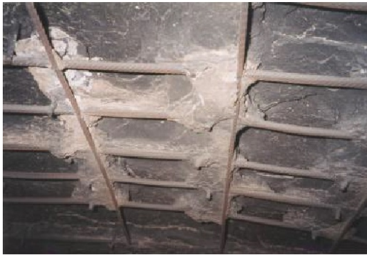
(a) Danos por fogo no revestimento de concreto do Channel Tunnel, França-Inglaterra.
