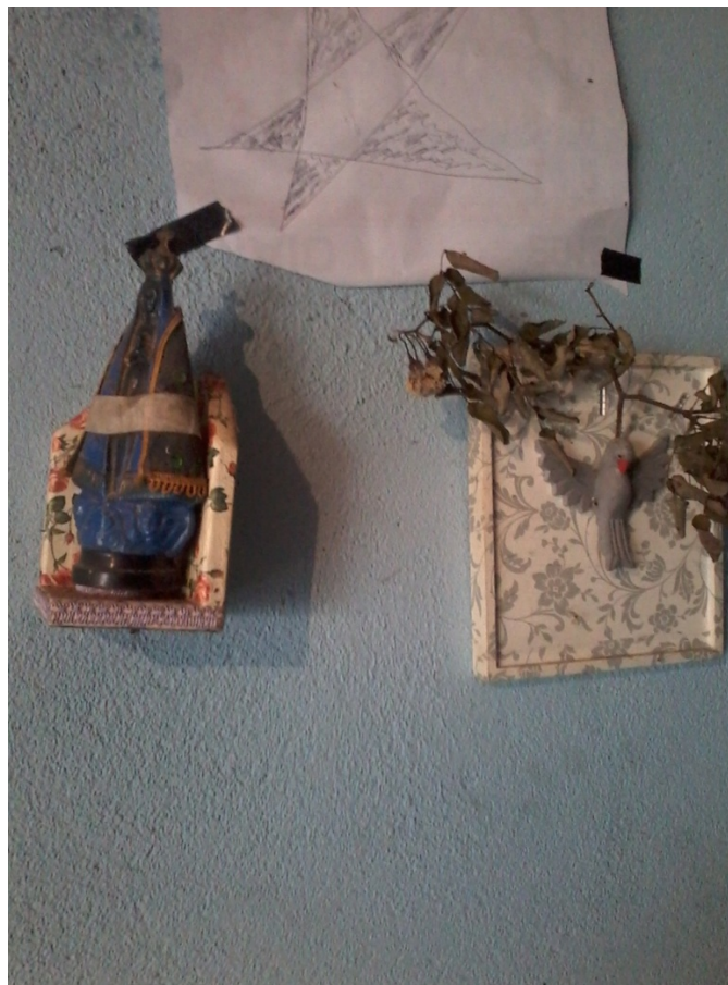
Figura 20 - Parede da casa da D. Maria.
