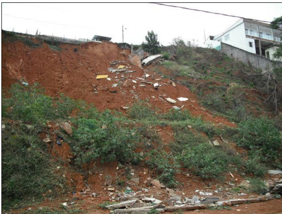
Foto 8: Escorregamento ocorrido no ano de 2012, na rua Manoel Moreira de Moraes. Fonte: Acervo fotográfico do próprio pesquisador.
