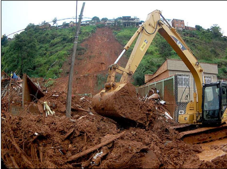
Foto 11: Deslizamento ocorrido no ano de 2009, no bairro Vila Ideal. Fonte: Tribuna de Minas.
