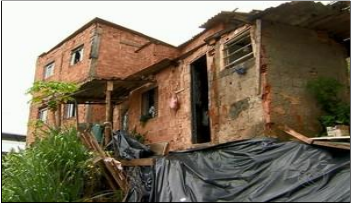
Foto 4: Residência em área de alto risco no bairro Vila Ideal. Fonte: Acervo pessoal.
