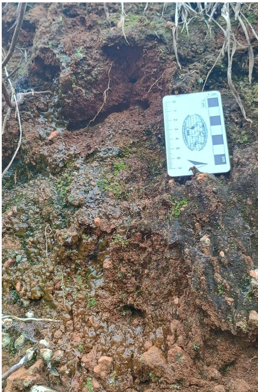
Figura 26 - Ponto de exfiltração de água condicionado pela fácies bauxítica do perfil.
