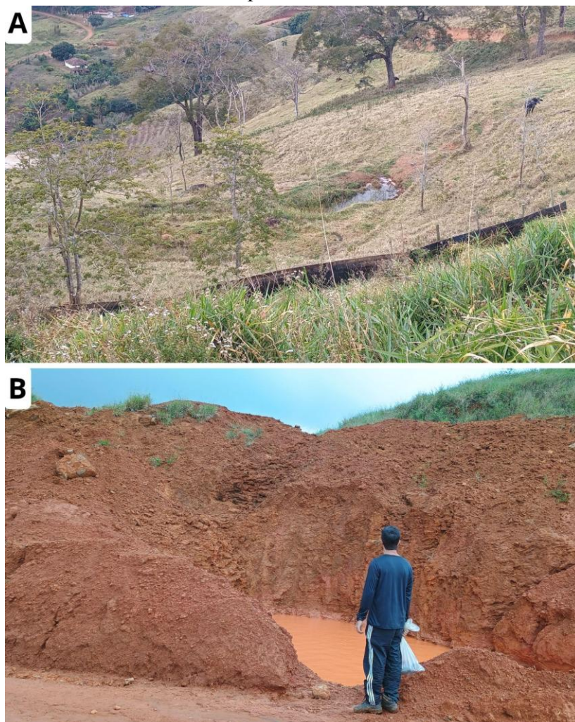
Figura 42 - A) Uma das contenções instaladas pela empresa para preservar os corpos hídricos de enxurradas de água e sedimentos. B) Uma das bacias de contenção construídas na estrada aberta pela mineradora.
