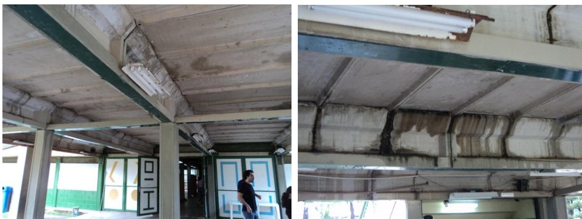
Figura 78: Vazamentos na cobertura (Fonte: a autora, março/2015)
