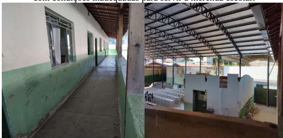
Figura 2 - Corredor superior estreito que dificulta circulação dos alunos e refeitório inacabado com condições inadequadas para servir a merenda escolar.
