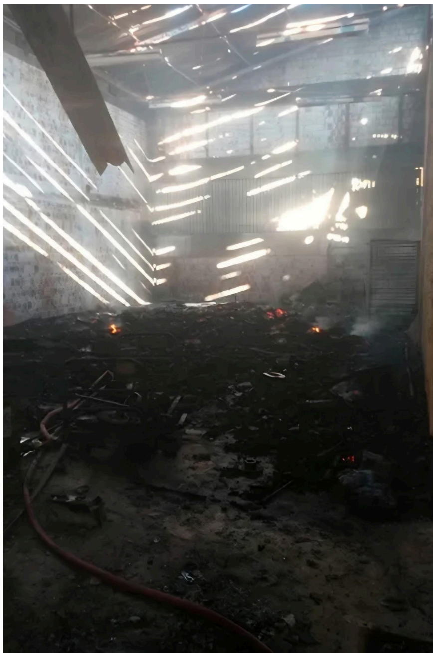
Figura 10– Incêndio do galpão, 21 de agosto de 2021.
