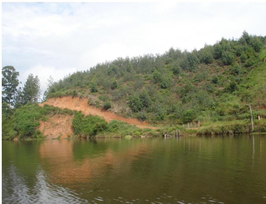
Fotografia 17: Erosão e movimento de terra na margem de trás do PR1 (março de 2010).
