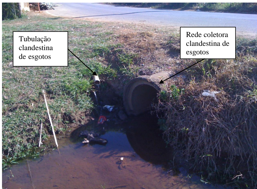
Fotografia 10: Rede coletora clandestina de esgotos, direcionando os efluentes para tributário do ribeirão dos Burros, à montante do PT2 (setembro de 2010).
