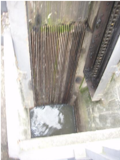
Figura 5: Gradeamento de limpeza mecanizada. ETE Barbosa Lage - CESAMA, Juiz de Fora Fonte: Acervo do autor, 2010
