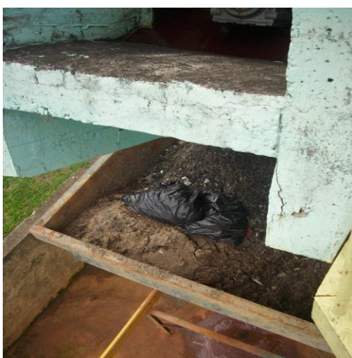
Figura 7: Areia retirada do desarenador – ETE Barbosa Lage - CESAMA, Juiz de Fora Fonte: Acervo do autor, 2010
