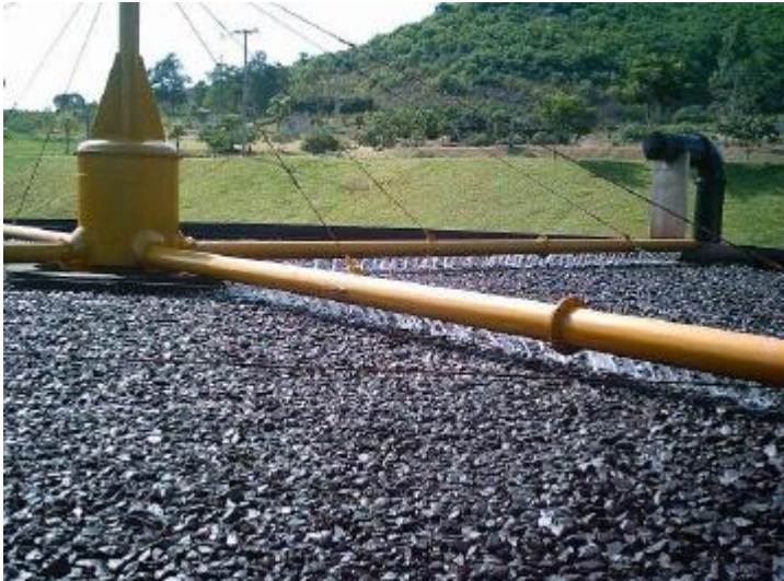
Figura 13: Filtro aeróbio percolador, com brita como meio de suporte Fonte: von SPERLING, 2005
