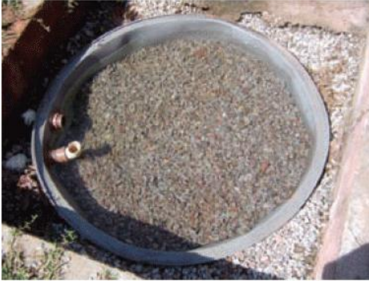
Figura 11: Filtro anaeróbio usando brita como meio de suporte Fonte: PROSAB – UFSC, 2010
