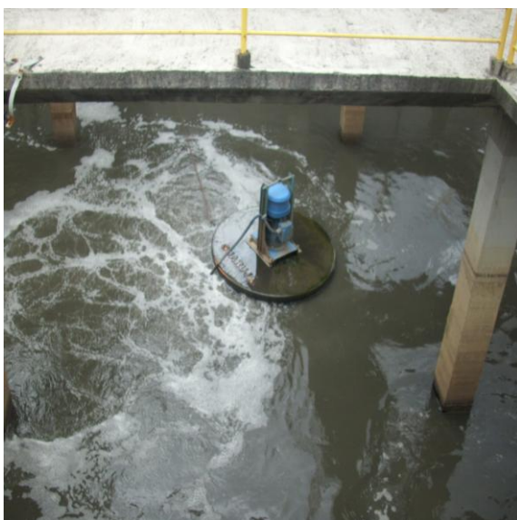
Figura 9: Tanque de equalização com misturador de superfície– ETE Barbosa Lage - CESAMA, Juiz de Fora Fonte: Acervo do autor, 2010
