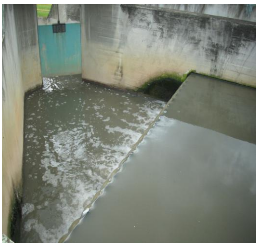
Figura 6: Desarenador – ETE Barbosa Lage - CESAMA, Juiz de Fora Fonte: Acervo do autor, 2010
