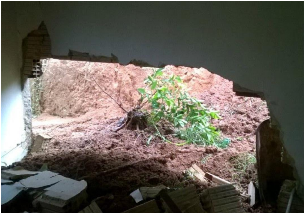
Figura 14-Episódio de deslizamento no dia 13/01/2017
