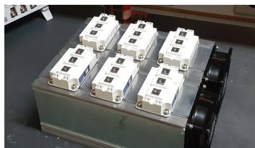
(d) Montagem final dos dissipadores de calor, com os módulos IGBTs instalados, sobre a chapa metálica de suporte do estágio de potência.
