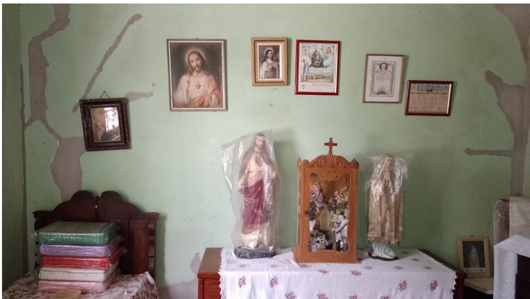
Imagem 13: paredes danificadas do quarto de Dorvina
