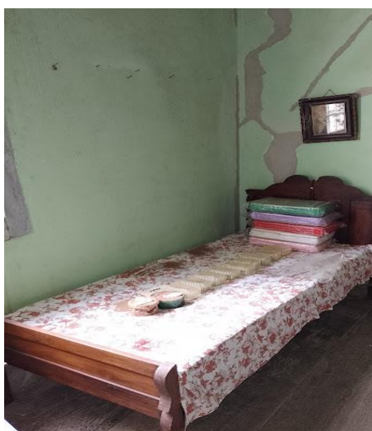
Imagem 14: Colcha da cama de Dorvina com sinais de cupins no quarto
