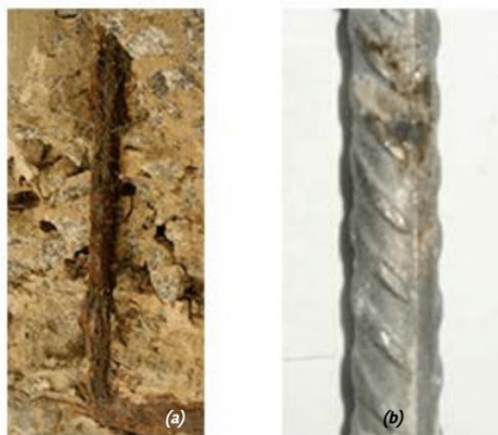
Figura 5 - Aparência superficial da corrosão generalizada desencadeada pela carbonatação do concreto (a) e da corrosão puntiforme desencadeada pela ação dos íons cloreto (b).
