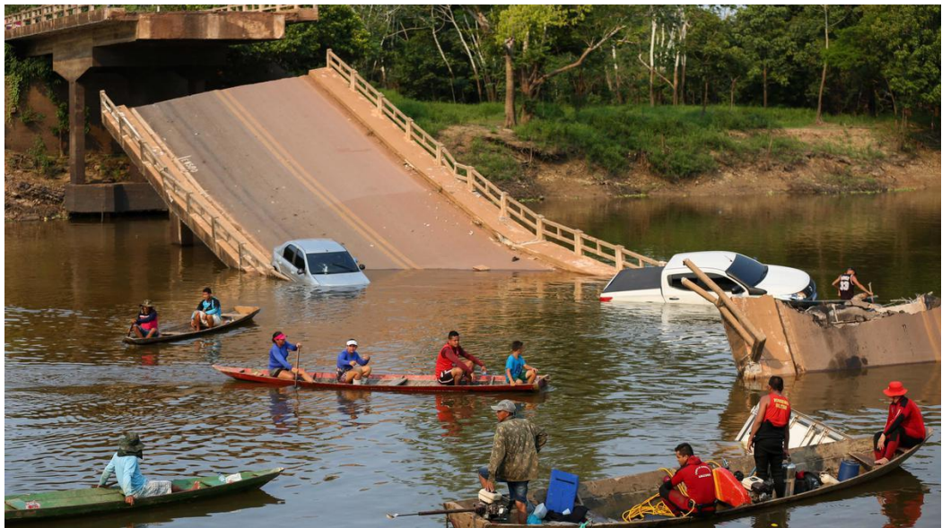
(c) Colapso de Ponte no Estado do Amazonas, 2022 [10]
