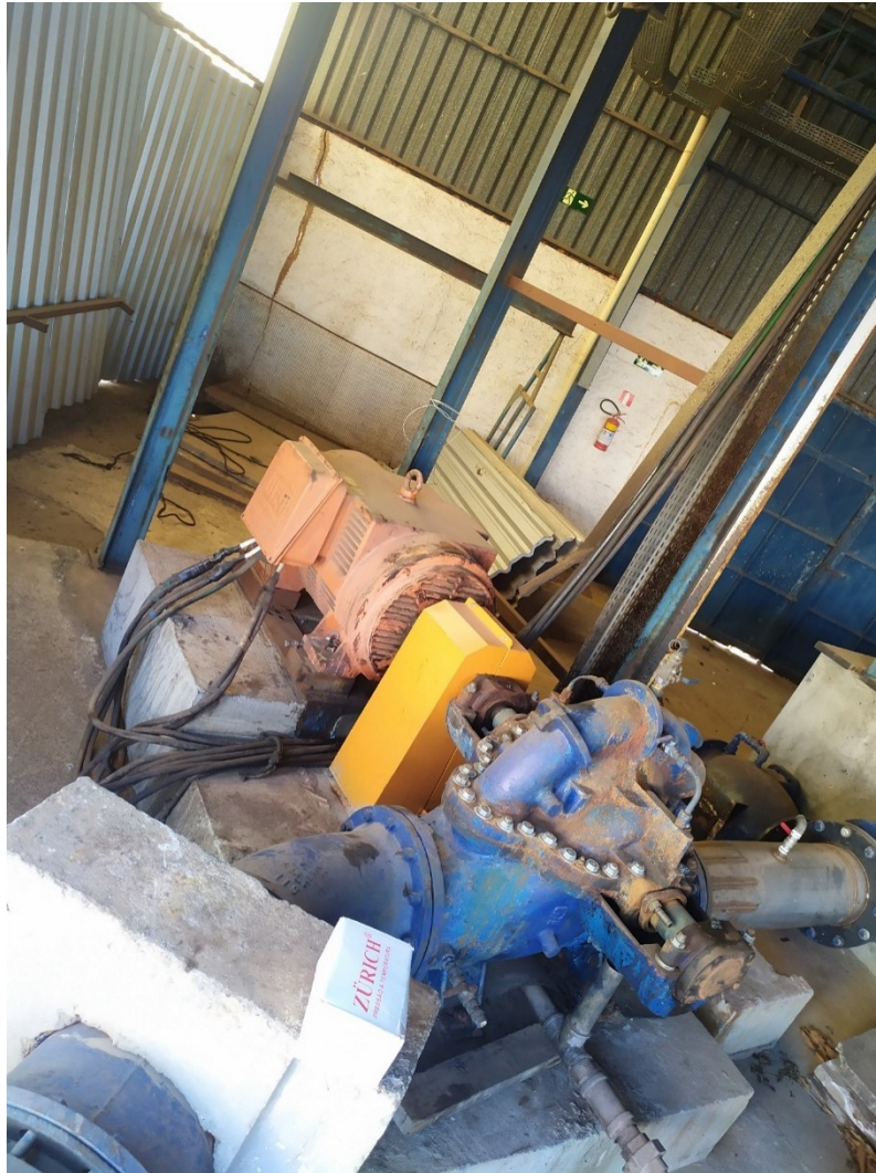
Figura 8 – Conjunto motobomba contemplado - ETAI
