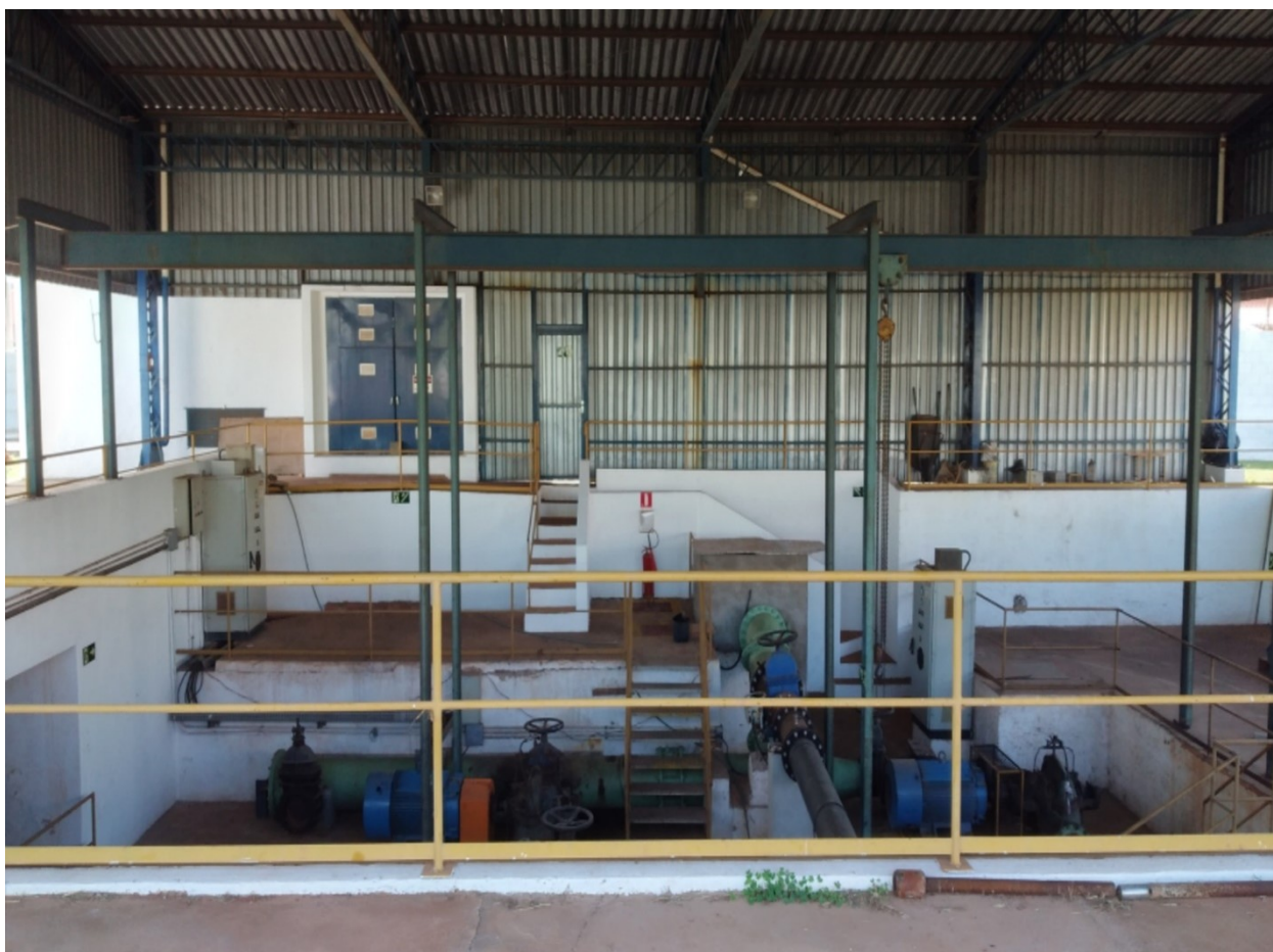
Figura 7 – Casa de máquinas ETA II
