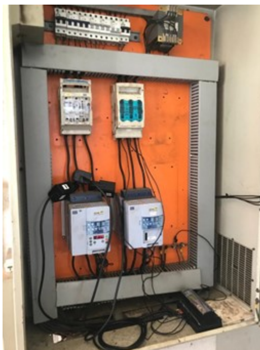
Figura 18 – Medidor instalado no QCM do conjunto - ETA II
