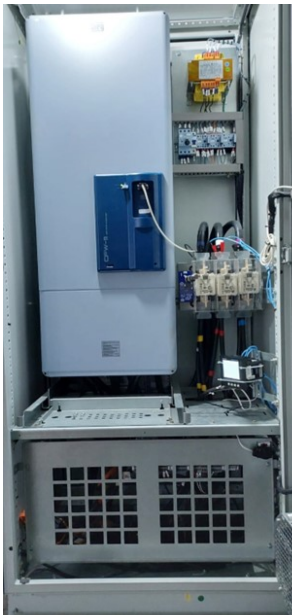
Figura 27 – Medição de energia no novo conjunto - ETA I
