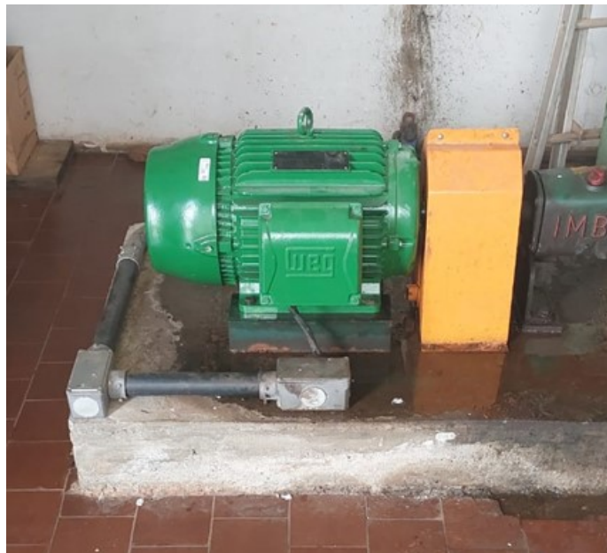
Figura 26 – Conjunto proposto instalado - ETA II
