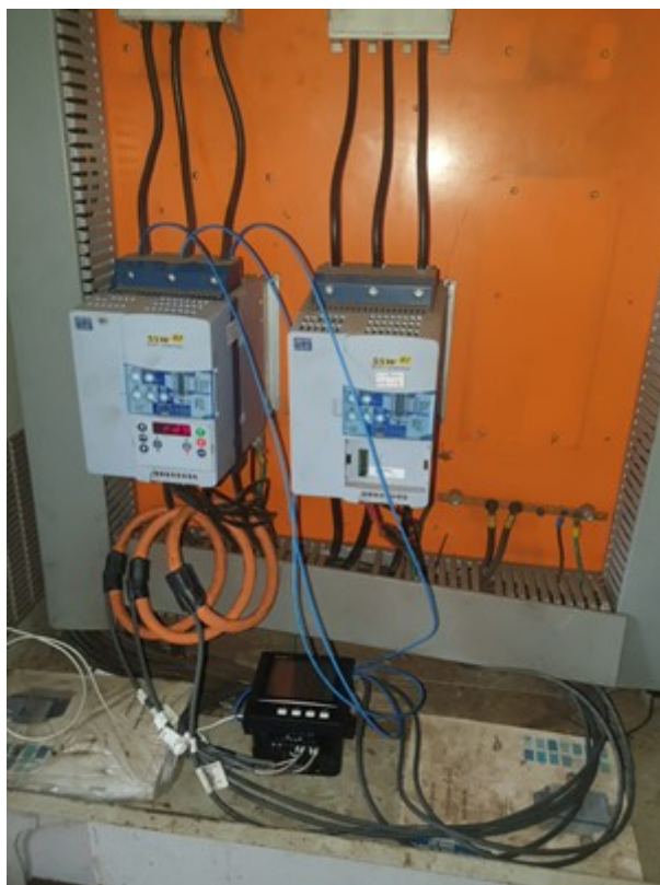
Figura 28 – Medição de energia no novo conjunto - ETA II
