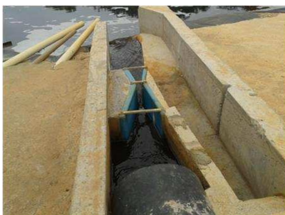
a) Calha Parshall
