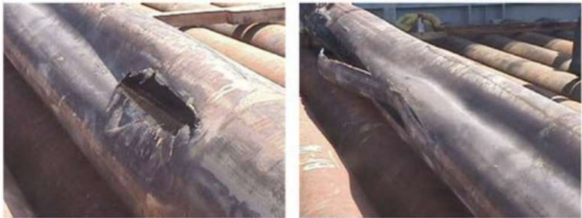
Figura 1.1 – Revestimento de 16” colapsado
