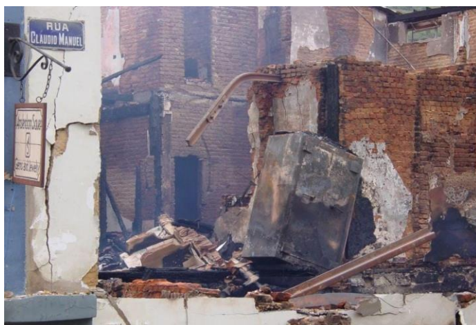
Figura 20 – Foto 1 do cenário após o incêndio no Hotel Pilão (2003).
