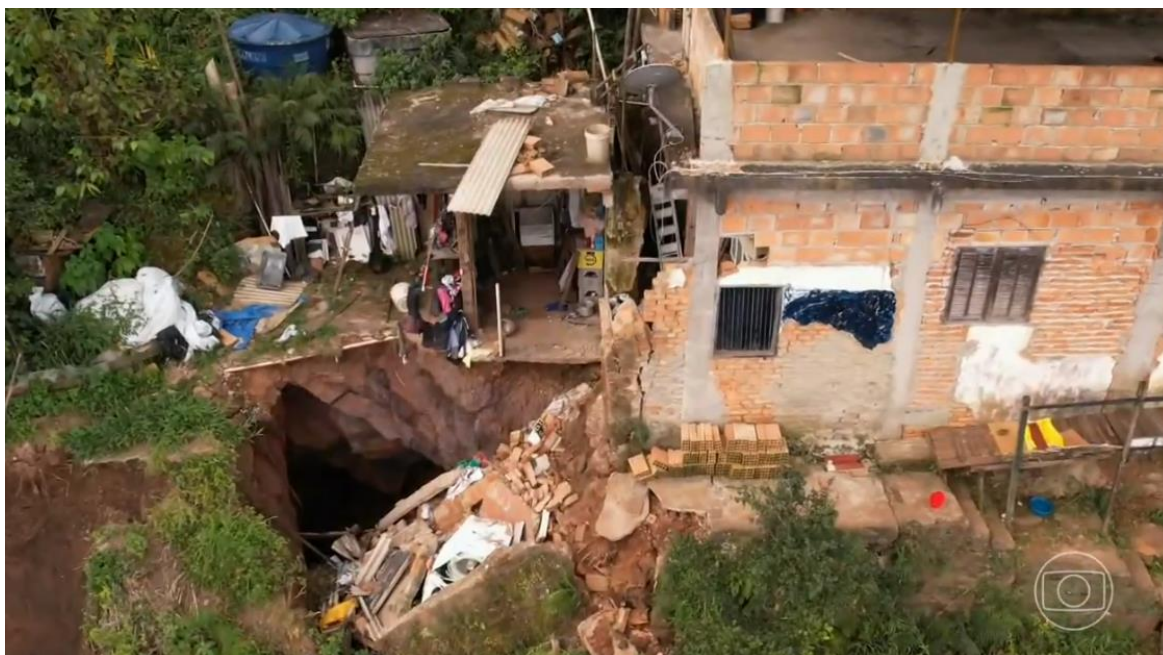
Figura 30 - Desabamento de casa no bairro Alto da Cruz devido a existência de mina abandonada.
