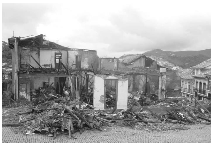
Figura 21 – Foto 2 do cenário após o incêndio no Hotel Pilão (2003).
