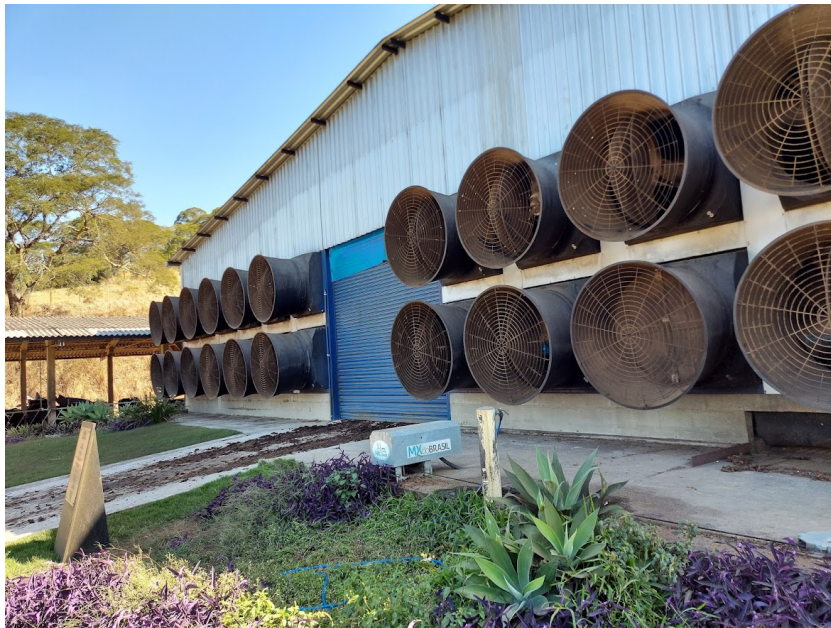
Figura 7 - Conjunto de exaustores do Compost Barn .
