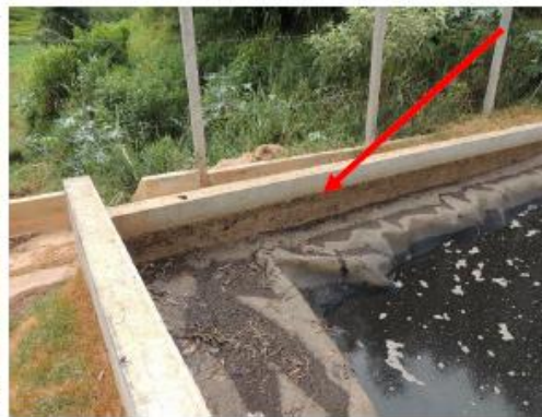
Figura 52: Transbordamento da lagoa de chorume.
