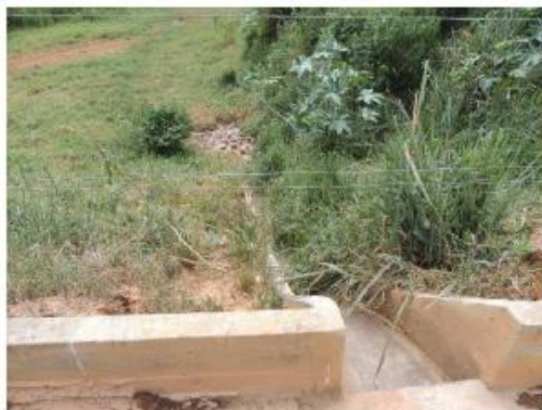
Figura 49: Escoamento pluvial para o terreno vizinho.
